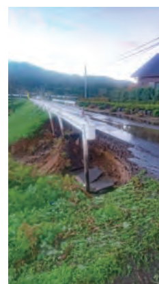
土砂崩れの様子
